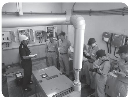
電源室の様子
