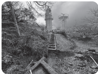
写真6 震災後～灯台への通路が崩壊
