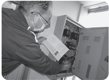
クランプ計による負荷確認
