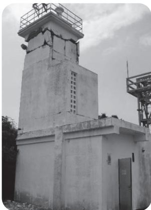
地震により亀裂発生！
