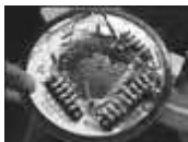
塩害によって腐食した端子板
